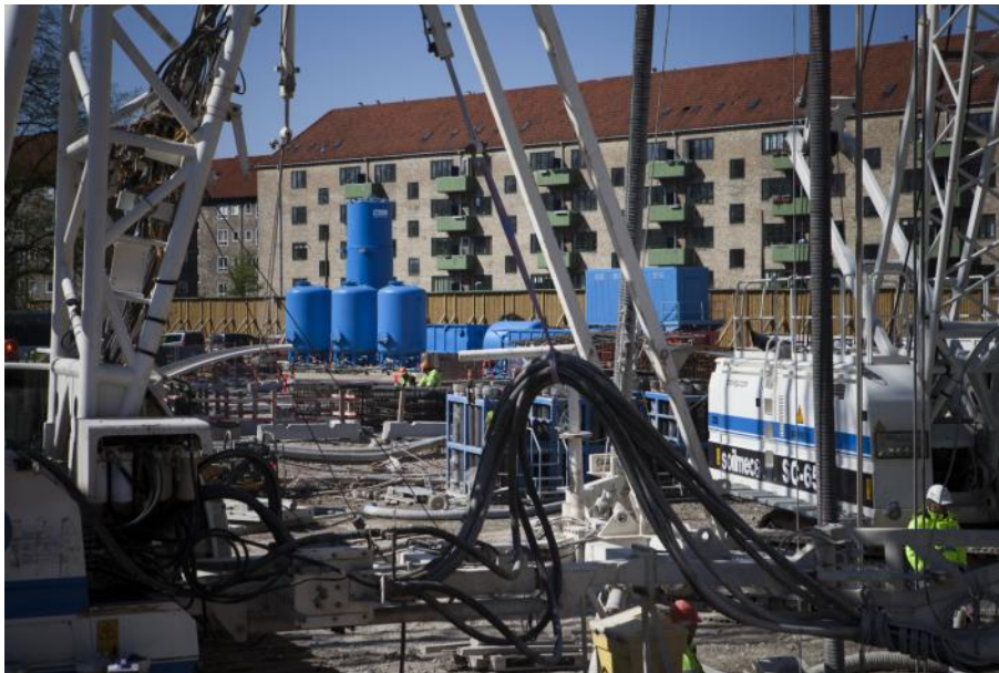
Abbildung 3: Wasseraufbereitungsanlage am Startschacht einer Tunnelbohrmaschine in Kopenhagen.
